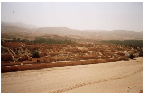
Le village de Tamerghza a été dévasté et abandonné suite à la crue de l'oued Gouiffa en 1969 (photo Y. ZAHAR : 1999)
